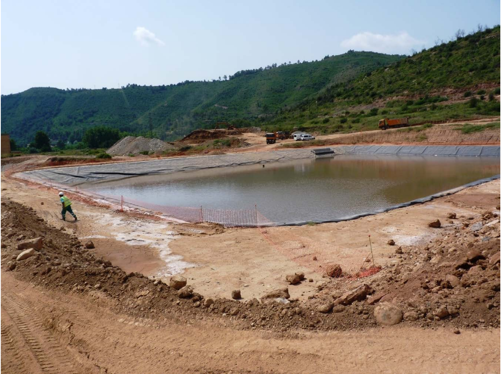
Bassa que s'omple amb aigua provinent del sistema de drenatge superficial.
